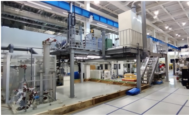
Figure 1: COI 棟内南西部の EP 設備エリア (~130 m²).
