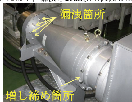
図3 同軸ダミー負荷からの電波漏洩箇所
