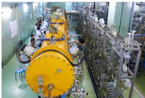
図8：S T Fトンネル内にて完成したクライオモジュールと高周波電力分配システム
