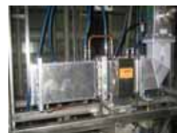
図5: 500kWサーキュレータ
