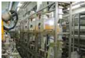
図3: リニア方式のPDSと空洞(Aクライオモジュール)
