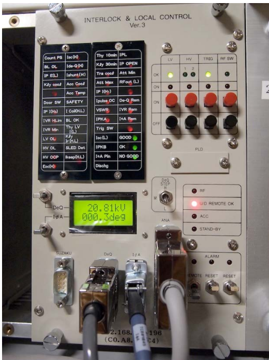
図 4: 新ローカルコントロールモジュール
