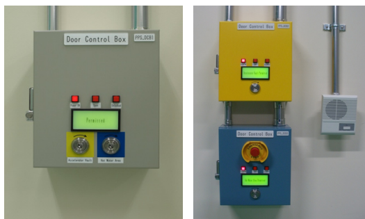
図 6: 扉開閉器 (左:搬入室入口用、右上:加速器室用、右下:ホット機械室用)
