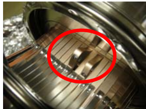
図7：損傷があるベローズチェンバーの内部写真。
