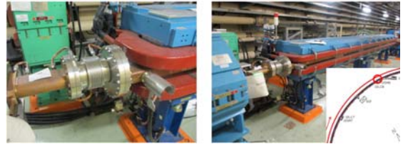
図10：損傷が見つかった撮影場所。
