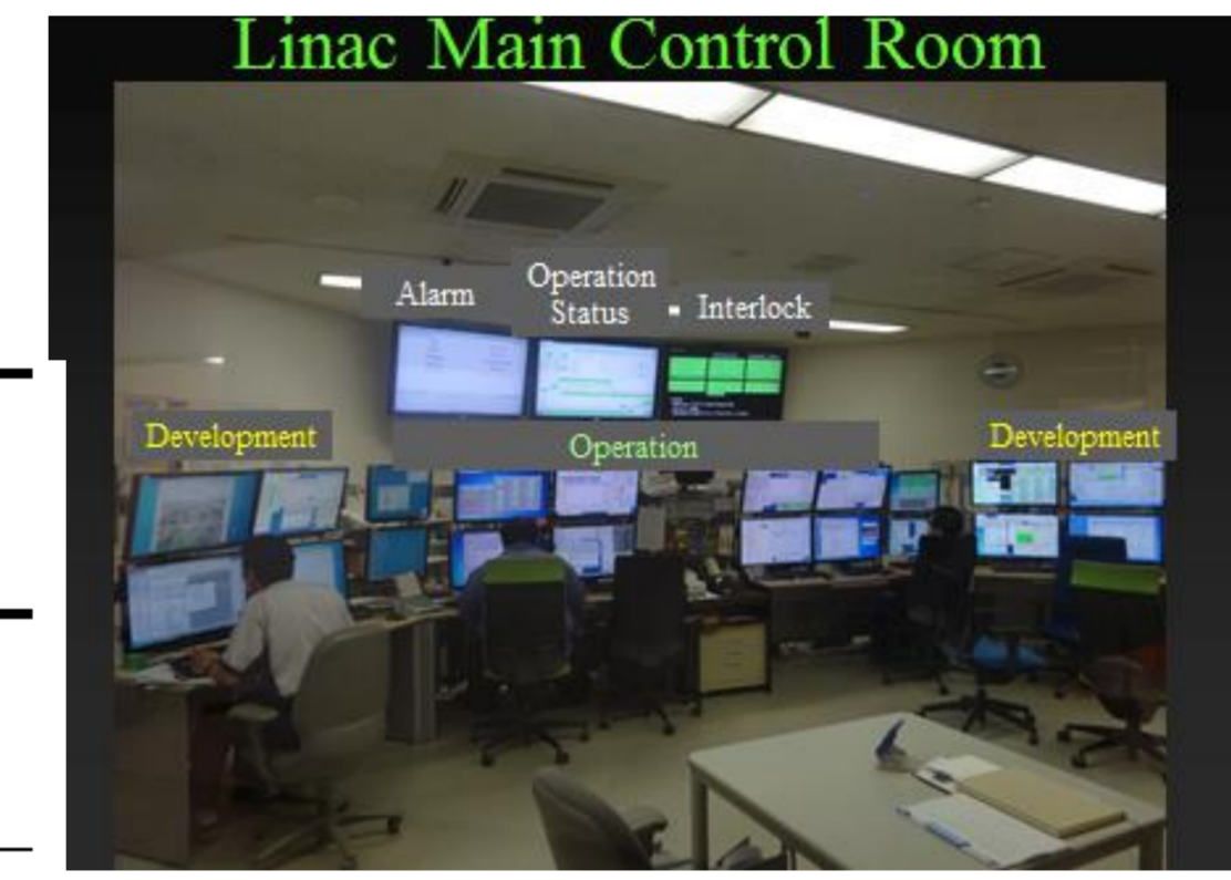
FIG. 2: 入射器制御室。
