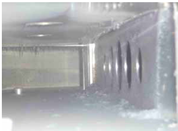
図 2 SF6 の放電による分解化合物が堆積した導波管方向性結合器内部
