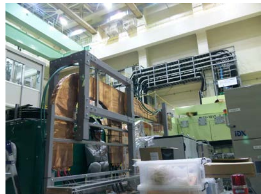
図 7 : RF Shield の強化 電力ケーブルラックの RF 遮蔽
